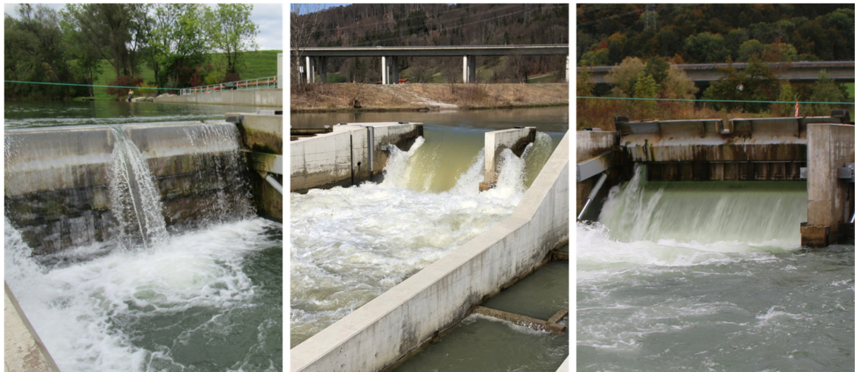
Abbildung 5 Verschiedene Betriebszustände des orografisch rechten Segmentschützes der Wasserkraftanlage in Großweil vom Unterwasser aus gesehen. Links: Überströmung des Segmentschützes mit 3–5% des Turbinendurchflusses, Mitte: abgesenktes Segmentschütz, rechts: angehobenes Segmentschütz.
